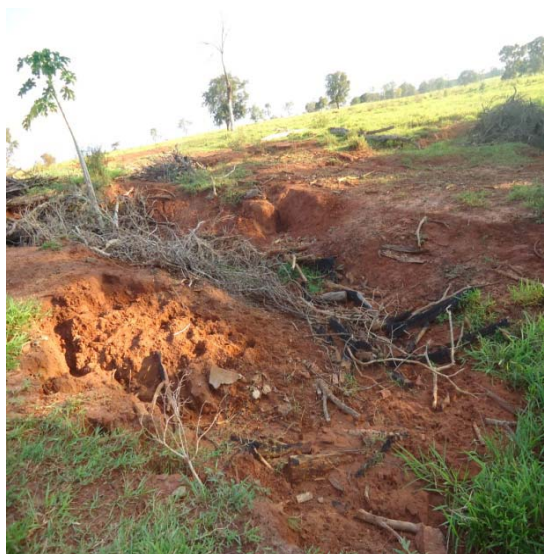
(A) Presença de processos erosivos
